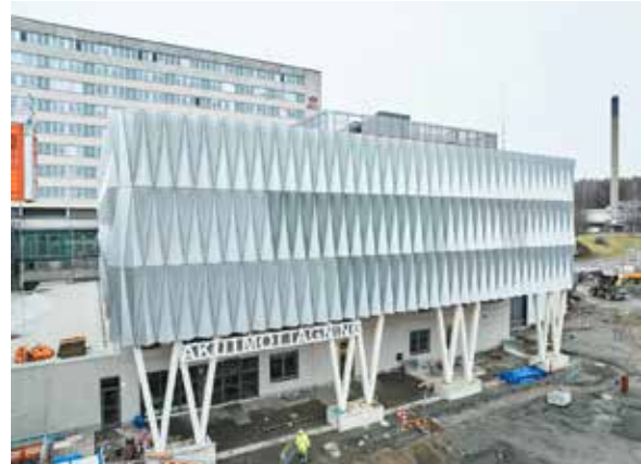
Nyköpings lasarett, nya entrén till akutmottagningen i hus N54. Akutmottagningen kommer att öppna upp för besökare senare i år.
